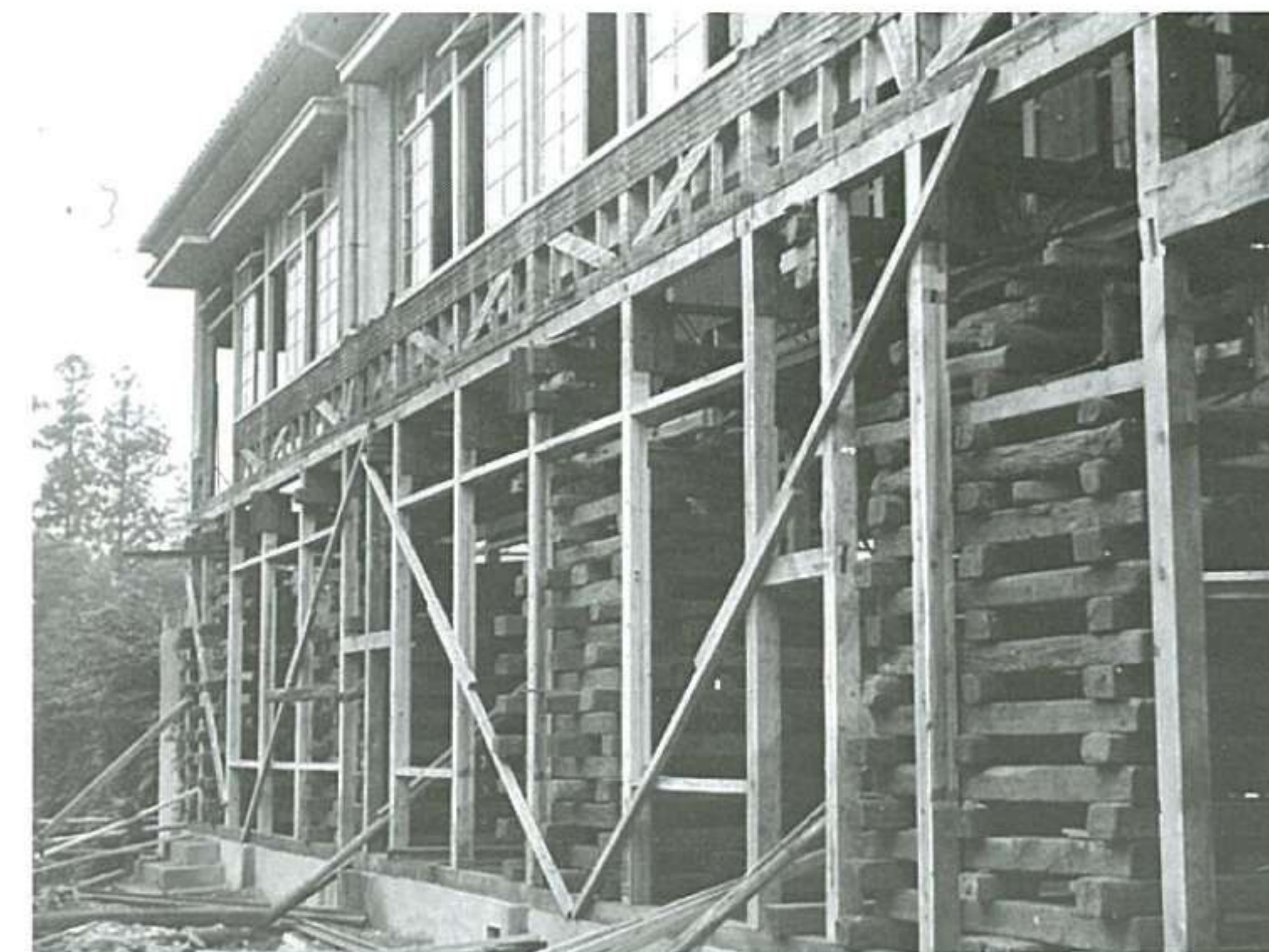
▲仙台・尚綱女子学園校舎 1階建を2階建にするため3.5M揚工事・延300㎡
